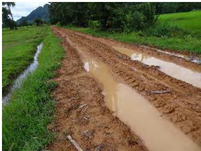
粘性分の多い土 現場近くの土を流用した結果 締め固めも不十分で 沈下したわだち跡に雨水が溜まった
