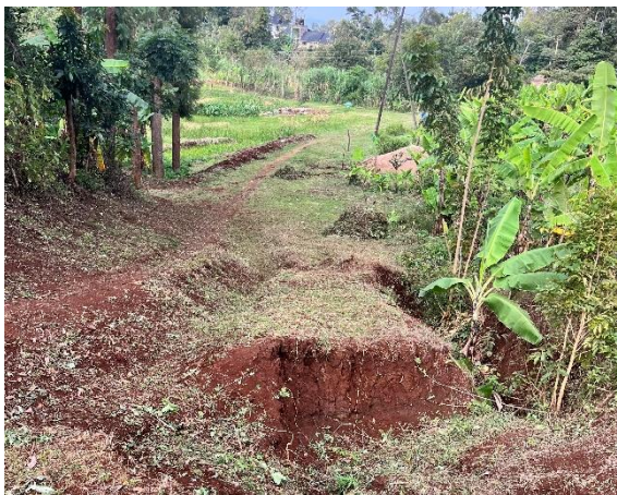
写真3 表層が削られている急勾配の道
