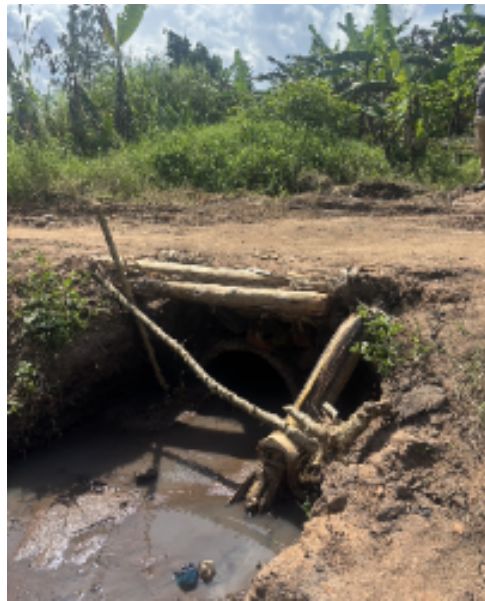
Photo2 トラックなどの重さに耐えられず壊れた排水管
