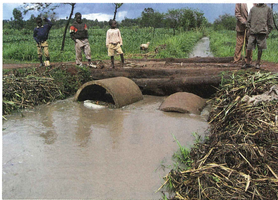
写真2 壊れかけの橋(ケニア西部)
